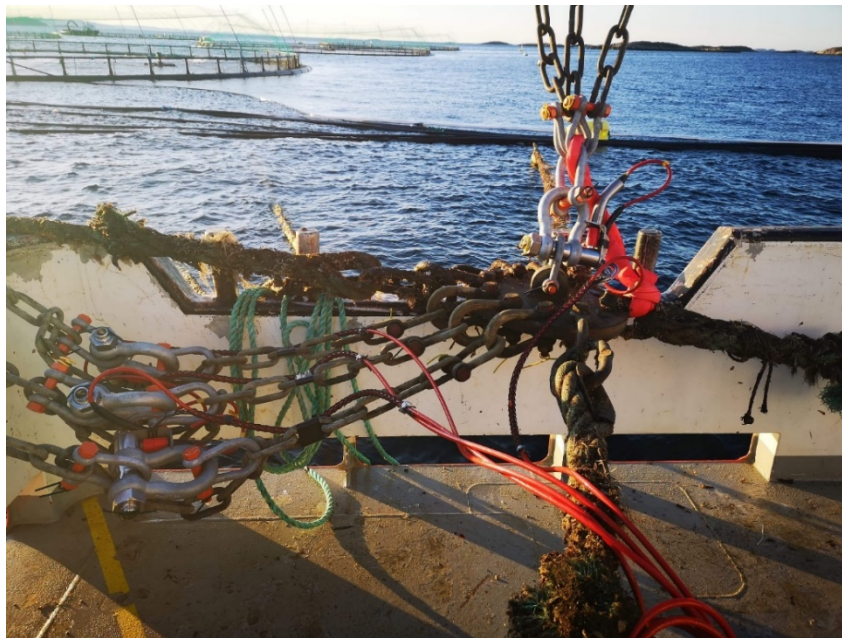
Figur 7 Lastsjakkell monterert i overkant av koblingsplate
